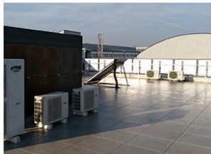
ompe di calore ad espansione idronica
